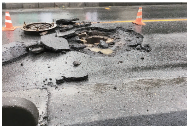
▲写真4：豪雨時の管きょ内の圧力上昇によりマンホールふた周辺の舗装ごと破損した事例
