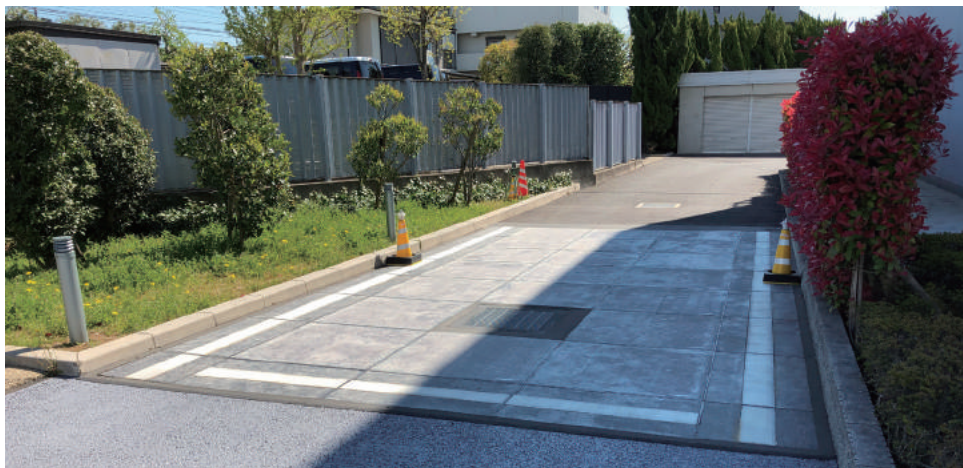
▲NIPPOの研究開発拠点「総合技術センター」(さいたま市)の敷地内に設置された太陽光発電舗装。日影になりやすい場所をあえて選定して検証を進めている
