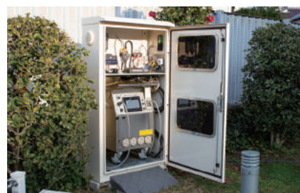
▲発電した電気のみで稼働する「独立電源型」蓄電システム。内蔵するバッテリーは可搬式で災害時の非常用電源としても活用可能
