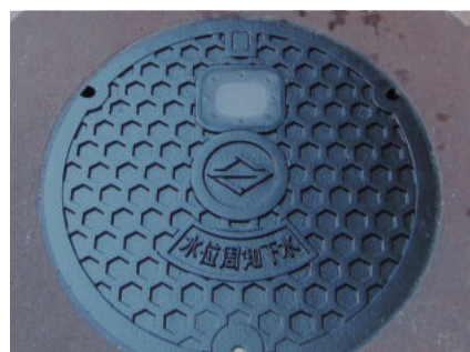
▲マンホールアンテナが設置されたマンホールふた
