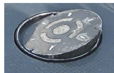
▲写真4:内圧作用時に蓋が外れた様子(開口部を閉塞した平受け(RC)蓋)
