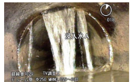
▲管ぎょ内への浸入
