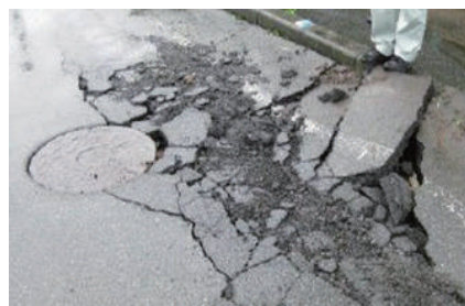
▲水圧による舗装等の破損
