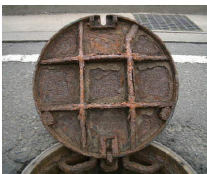
▲写真2:腐食の進行したふた
