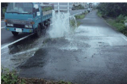
▲マンホールからの下水噴出
