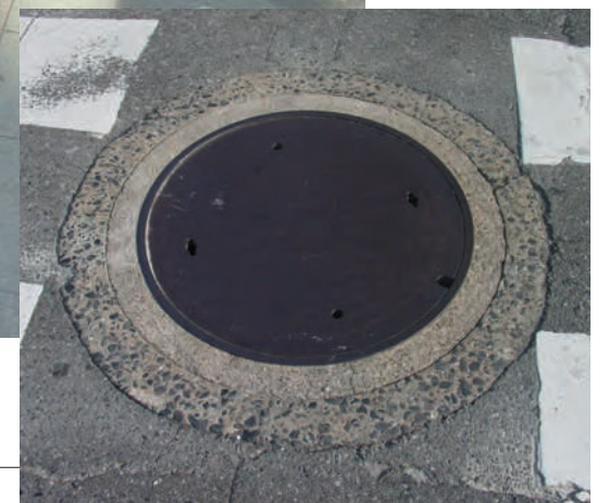
摩耗したマンホールふた
