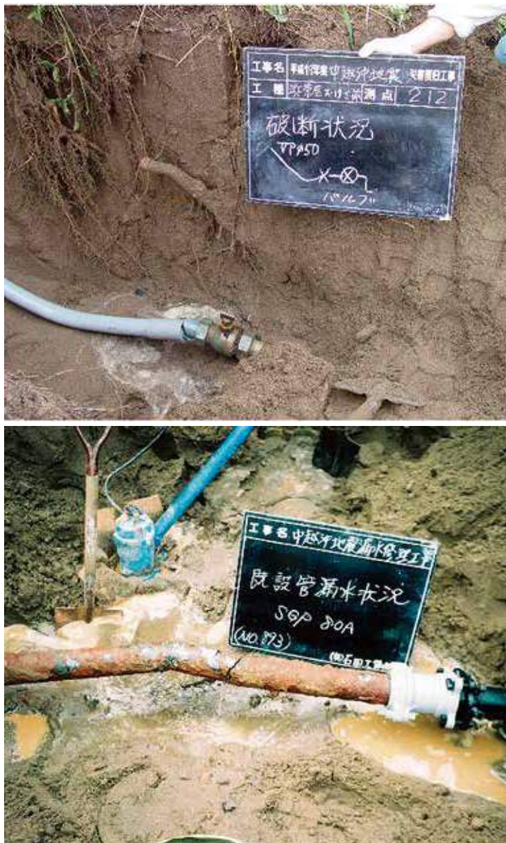
管路からの漏水や破裂 (厚生労働省の「平成19年(2007年)新潟県中越沖地震水道施設被害等調査報告書 平成20年3月」より)
