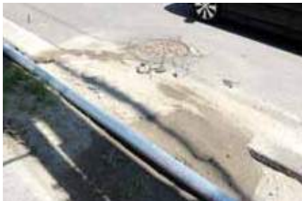
車道部のマンホール周辺舗装の破損
