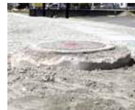
歩道部のマンホールの浮上
