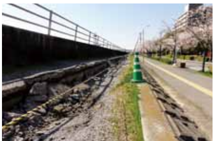
境川付近の段差
