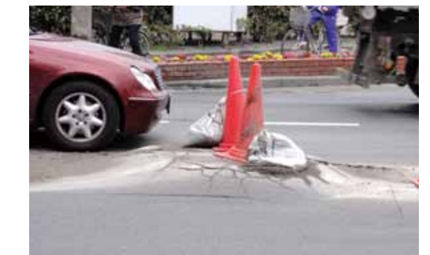
マンホールの浮き上がりによる道路への突きだし
