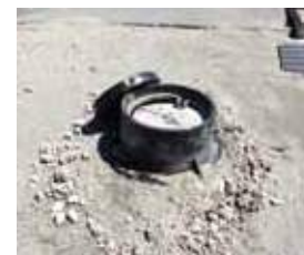
歩道部の小型防護ふたマンホールの浮上
