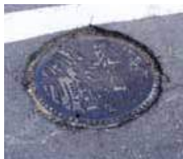
マンホール周辺舗装の隆起
