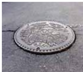
マンホール周辺舗装の沈下
