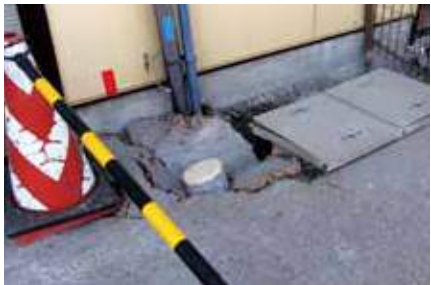
汚水枡部の隆起とふたのズレ
