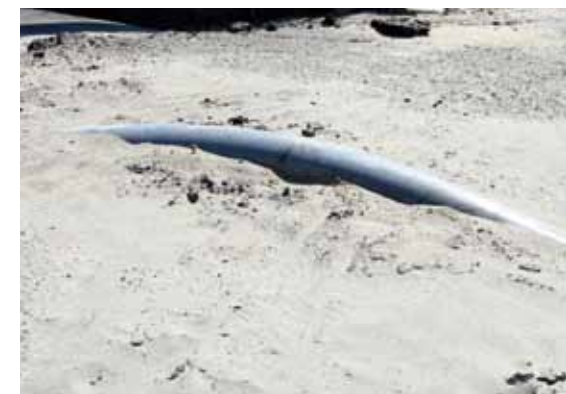
地盤の流動により地上に飛び出た管路
