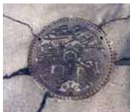
マンホール周辺舗装のひび割れ
