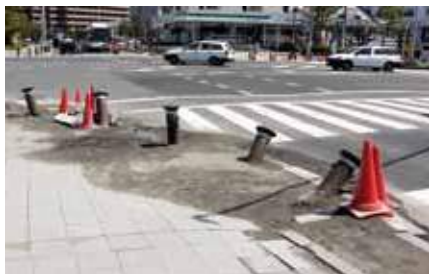
車止めの傾斜 液状化噴砂
