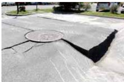
地下ボックスの形状に合わせひび割れと舗装の陥没が発生
