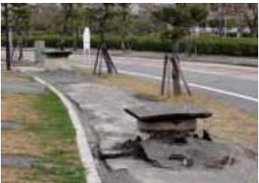
歩道部のマンホールの浮上
