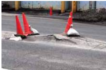
車道部センターライン付近のマンホールの隆起
