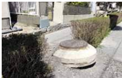
歩道部のマンホールの浮上
