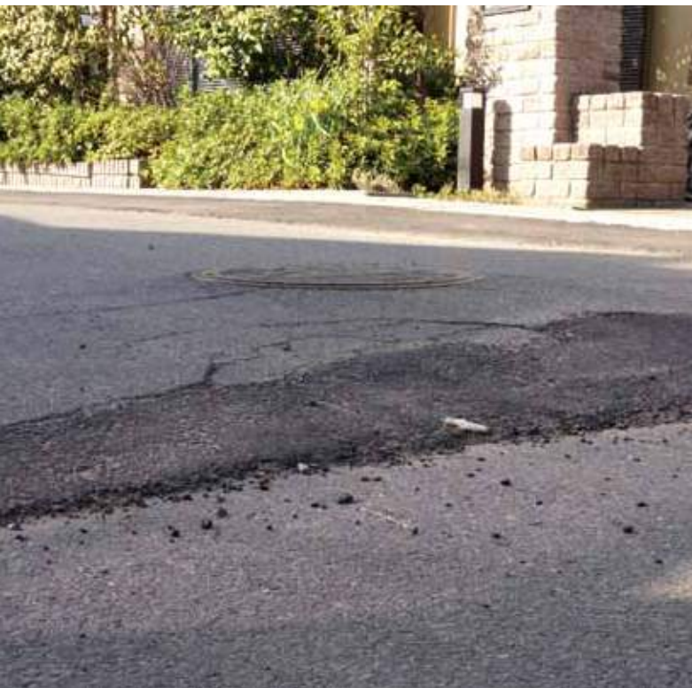
車道部のマンホール周辺舗装の沈下
