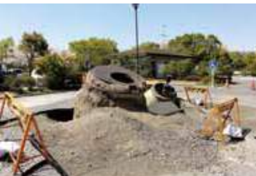
耐震性貯水槽に設置されたマンホールの浮上
