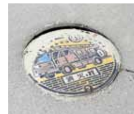
歩道部の消火栓の陥没
